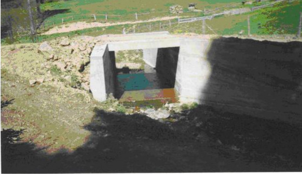
Şekil 3. Tekniğine uygun yapılmamış bir köprü
