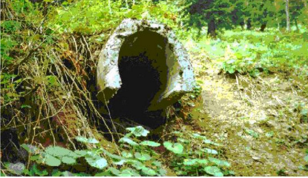
Şekil 1. Büz çıkışında yapı eksikliğinden kaynaklanan tahribat
